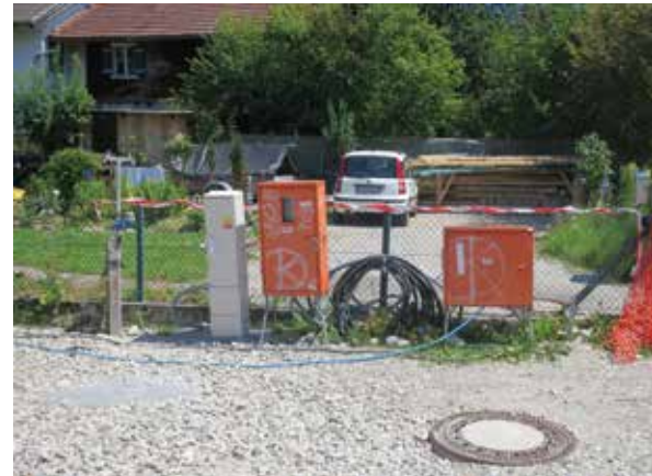
Anschluss Baustrom und Bauwasser
